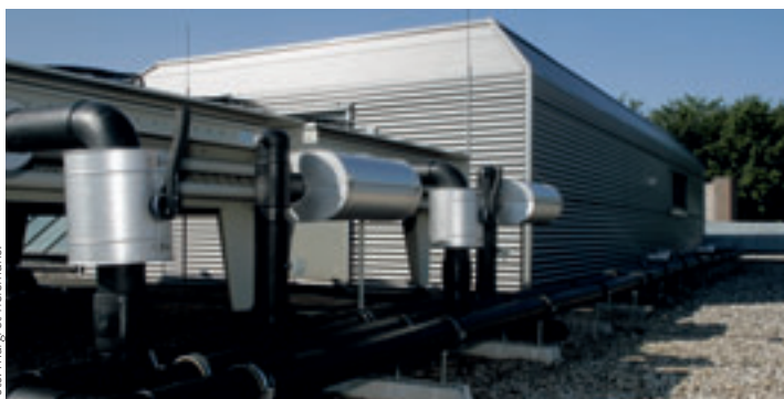
4. Onderdeel van de koelinstallatie.
