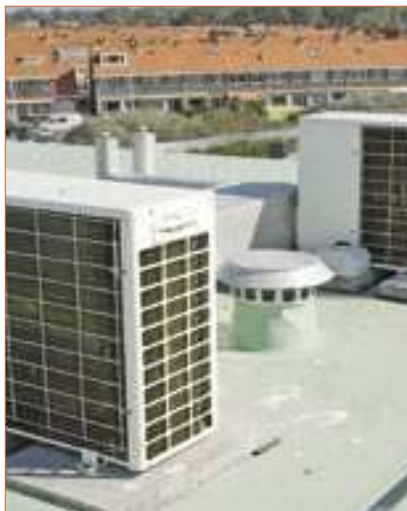
De koelinstallaties op het dak.
