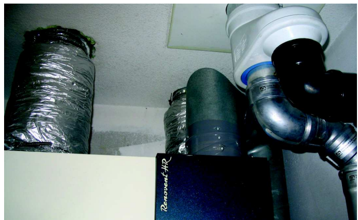
Zo staat het niet in de installatiehandleiding.
