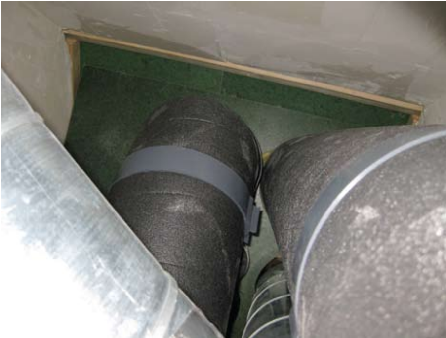
Eén van de buizen is niet goed verlijmd, zodat lucht van buiten de woning inkomt.
