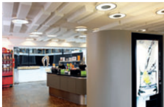
8. Akoestische baffles aan het plafond (Waterschapskantoor Ridderkerk).
