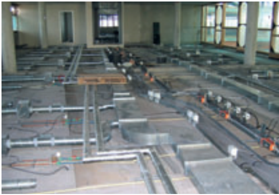
11. Techniek in de vloer.
