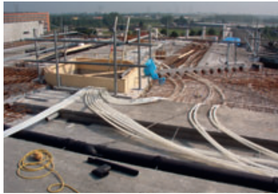
13. Techniek in de dakvloer.
