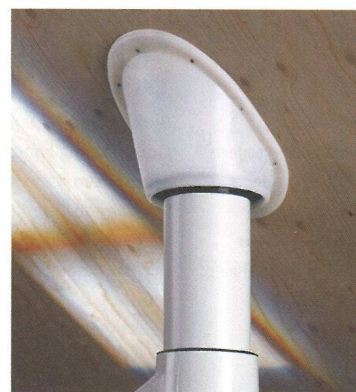
De dakdoorvoer is een veelvoorkomend lek. Vakkundige uitvoering of gebruik van goede manchetten kan warmteverlies voorkomen.
