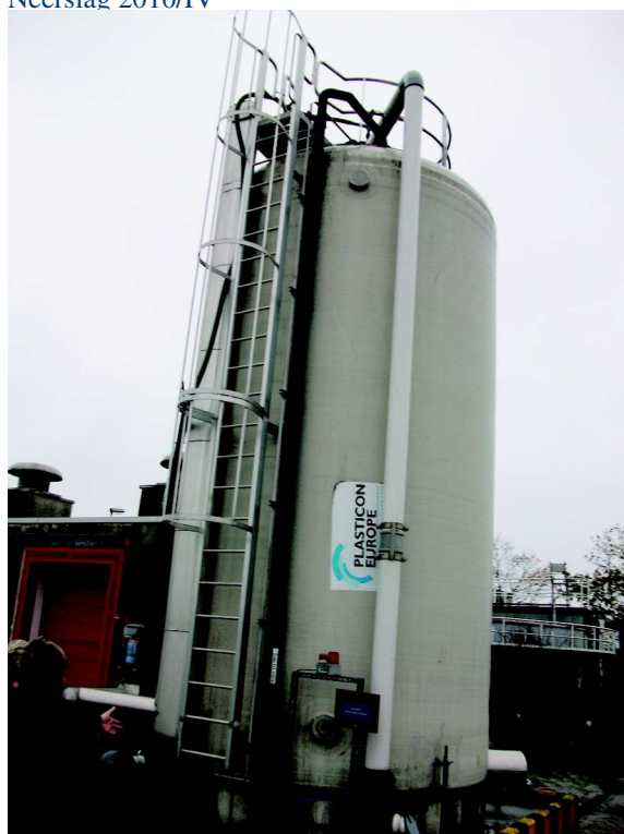
Tank geschikt voor co-producten De Nieuwe Waterweg.
