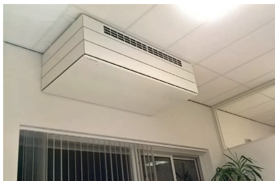
Per ruimte is een ventilatie-unit geplaatst, dit heeft de nodige kanalen door de school voorkomen.
