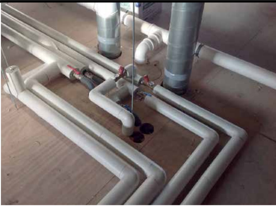
Op de zolder kan de installatietechniek in het zicht blijven.
