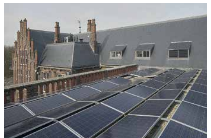
Op het dak zijn zonnepanelen geplaatst die bijdragen aan Energielabel B.
