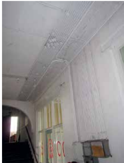
In de oude situatie was sprake van veel opbouw installatietechniek.
