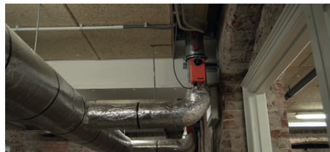
Stijgkanalen van het BaOpt/Climotion-systeem in de kelder die elk uitmonden in een uitblaasrooster in een vertrek. Elk kanaal is voorzien van kleppen (op de foto het oranje kastje van Kieback&Peter), die vanuit de kamer te bedienen zijn. Foto: Tijdo van der Zee
