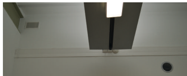
Elke kamer heeft één inblaasroostertje en één overlooprooster richting de gang. De ventilatiekanalen zijn weggewerkt achter een ongeveer twintig meter diepe voorzetwand. Foto: Tijdo van der Zee
